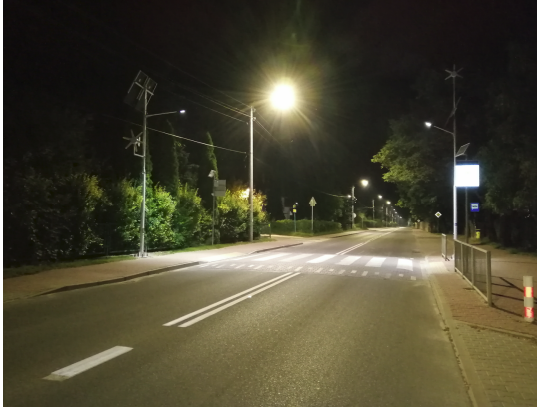
Doświetlenie przejścia dla pieszych ul. Szkolna w Starachowicach - DP 1811 T (0907T)
